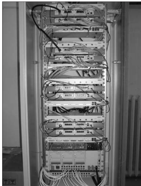
Stacja bazowa sieci LMDS.
